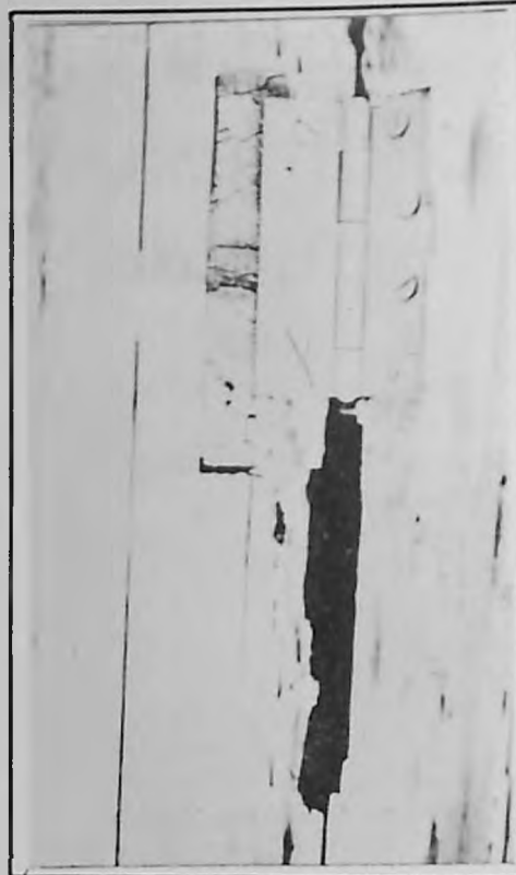
Deterioro por paililla
